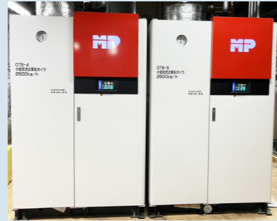
中央棟小型貫流ボイラ
