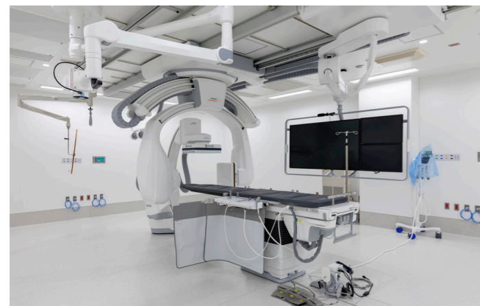
3階 IVR多目的血管撮影装置
